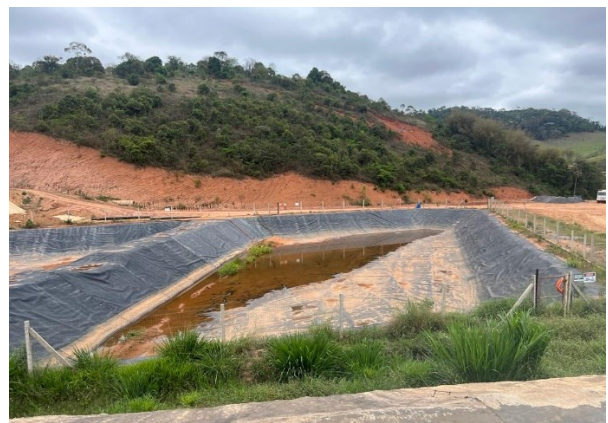
Imagem 4 – Lagoas de acumulação.
