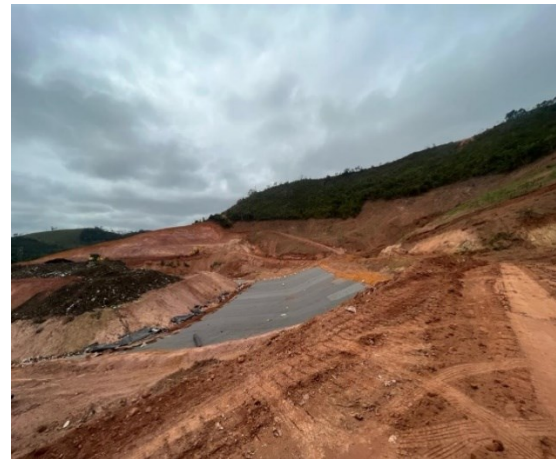
Imagem 2 – Vista das células em operação.
