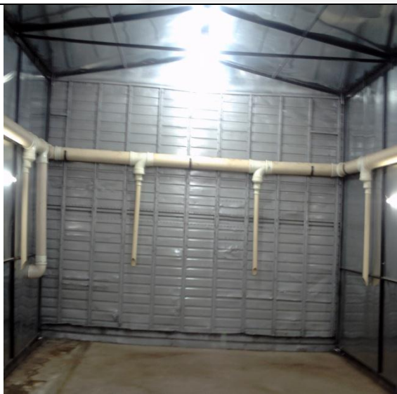
Foto 7. Cabine de pintura.
