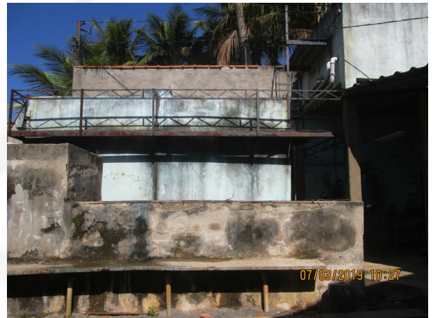
Figura 04: estruturas da ETE industrial – tanque onde ocorre o tratamento.
