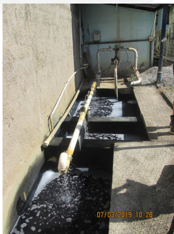
Figura 05: saída do efluente tratado.
