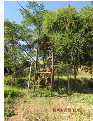
Figura 10: equipamentos utilizados na captação superficial no Ribeirão Roça Grande.
