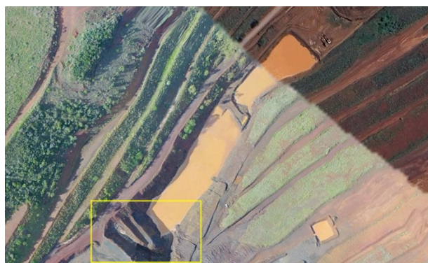
Figura 18 - Processos erosivos no talude interno do Sump 3.
