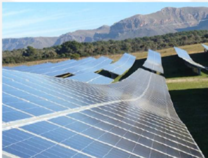
Figura 8: Linhas com módulos quadriláteros, vista lateral das hastes com os painéis. Fonte: RCA do empreendimento.
