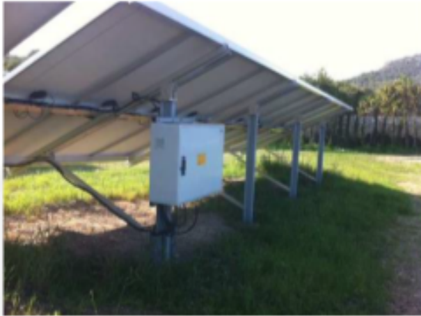
Figura 9: Quadro de nível junto aos painéis fotovoltaicos. Fonte: RCA do empreendimento.
