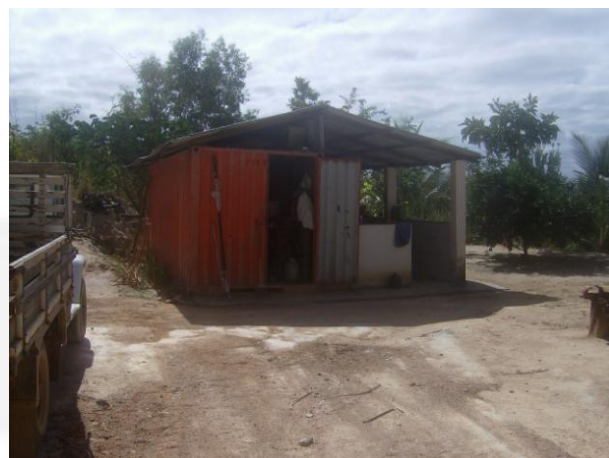
Foto 02. Galpão de armazenamento: Necessidade de adequações
