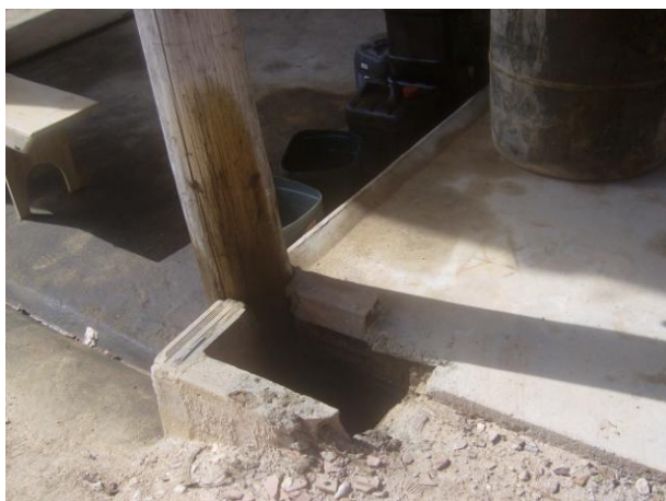
Foto 01. Oficina: Necessidade de adequações
