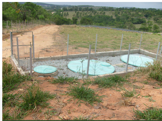
Foto 06. Tratamento esgoto sanitário
