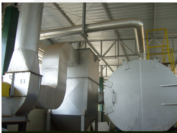
Foto 07. Multiciclone acoplado a saída da caldeira
