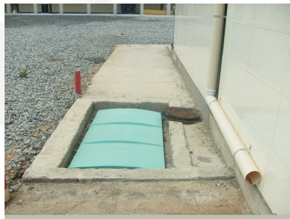
Foto 04. Caixa SÃO da área de lavagem de veículos
