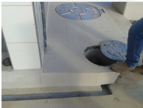
Foto 01. Linha de efluentes industriais
