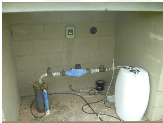
Foto 08. Poço subterrâneo com horímetro e hidrômetro
