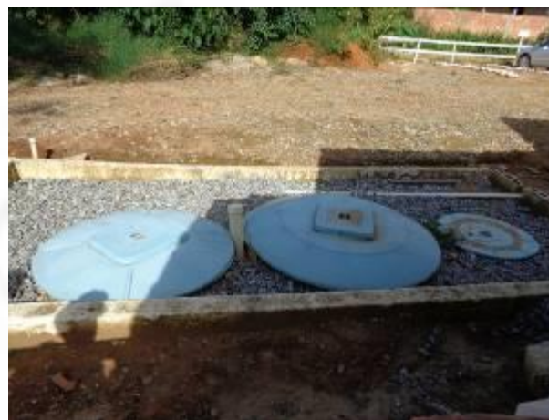
Tanque séptico e filtro anaeróbio
