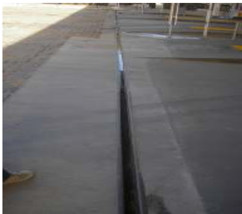
Foto 01. Detalhe da pista de abastecimento com canaletas.
