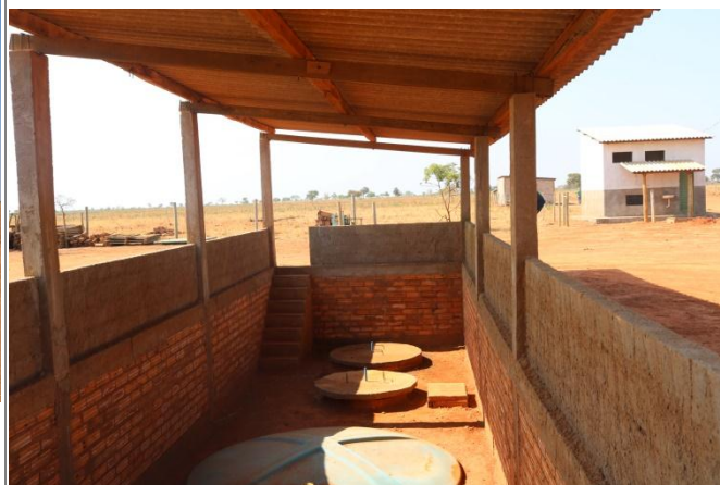
Foto 02. Sistema de tratamento de efluentes sistema fossa séptica/filtro anaeróbico/sumidouro.
