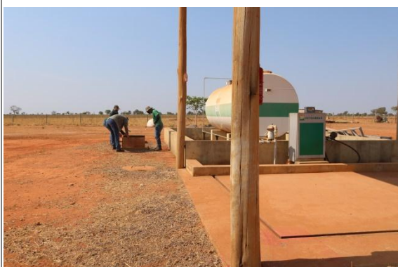
Foto 03. Unidade de abastecimento de combustível – tanque aéreo.
