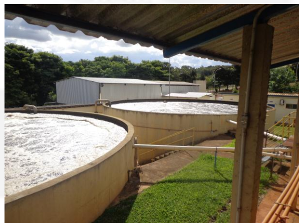
Lagoas de Tratamento da ETE
