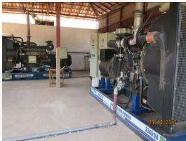
Fig. 04 - Gerador 120 e 330 Kva, que atende à demanda energética do empreendimento.
