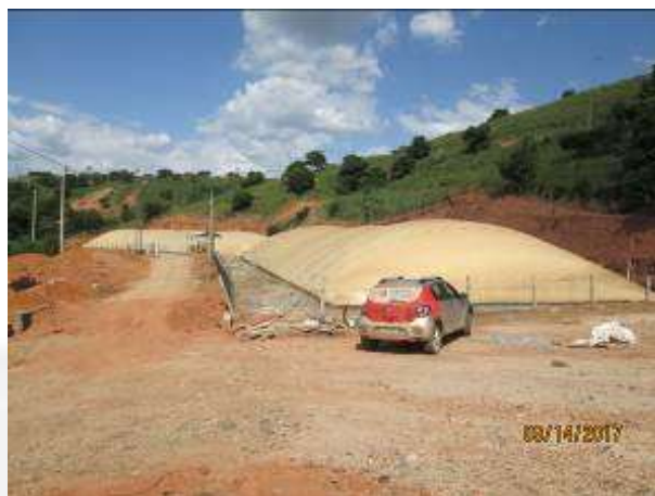
Fig. 06 - Duas células do biodigestor responsável por parte do tratamento dos efluentes da suinocultura.
