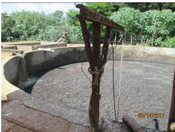
Fig. 05 - Caixa de equalização, início de sistema de tratamento dos efluentes
