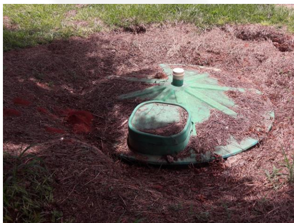
Foto 03. Filtro para tratar o efluente sanitário.
