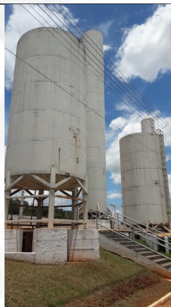
Foto 02. Reservatórios de água.
