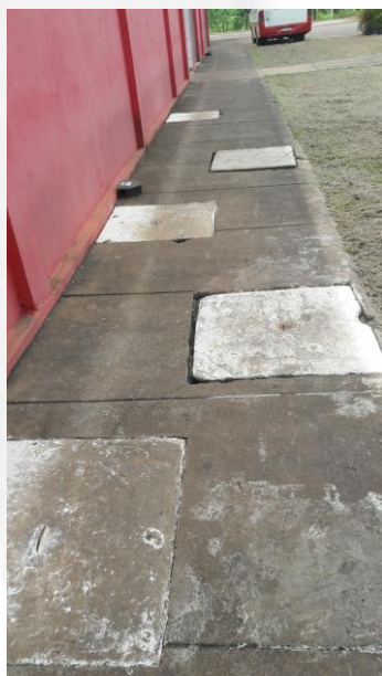
Foto 07. Caixas de passagem de efluente.
