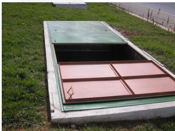
Foto 03. Sistema separador de água e óleo (Caixa SAO).
