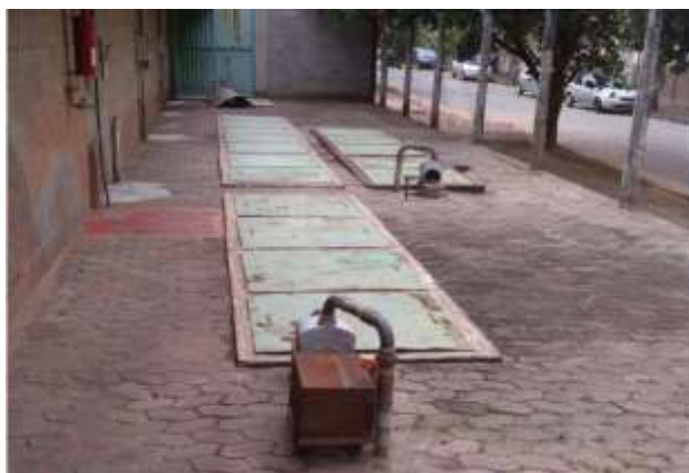
Foto 07. Caixas separadoras de água e óleo
