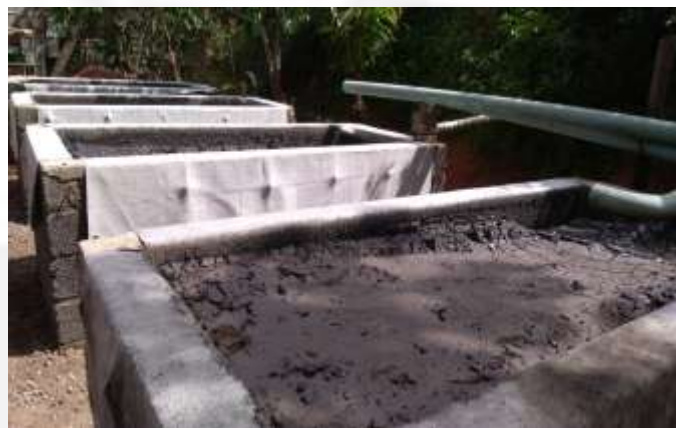
Foto 06. Leitos de secagem
