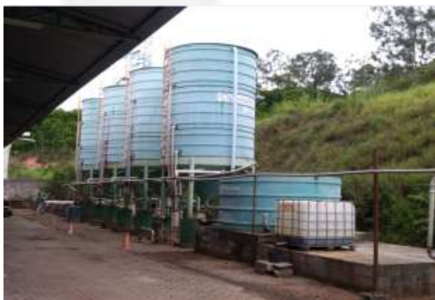
Foto 05. Estação de tratamento de efluentes - ETE
