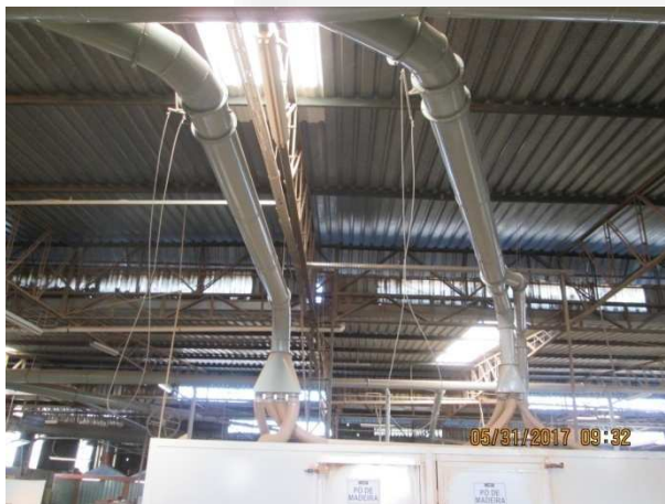
Foto 09. Sistema de exaustores para o pó de madeira
