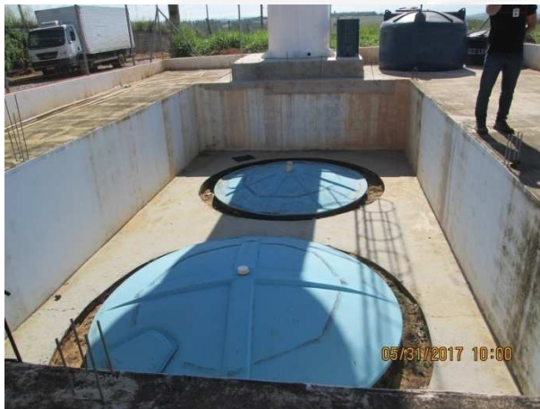
Foto 07. Sistema fossa séptica/filtro anaeróbio nº 01
