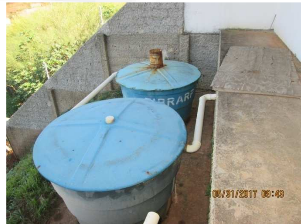
Foto 08. Sistema fossa séptica/filtro anaeróbio nº 02
