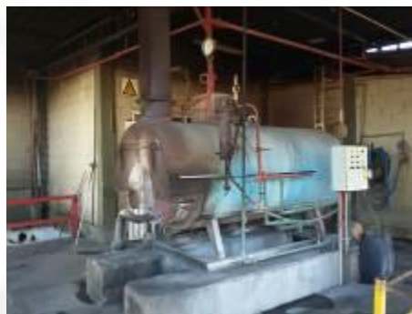
Foto 04. Caldeira para geração de calor.
