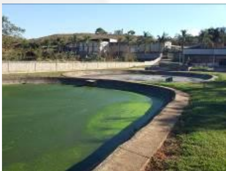
Foto 03. Estação de tratamento de efluentes.
