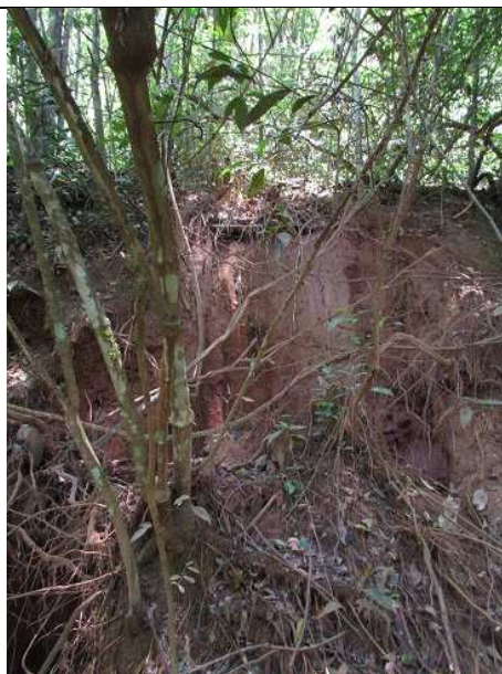
Foto 11: Processo erosivo abaixo de dispositivo de controle de drenagem.
