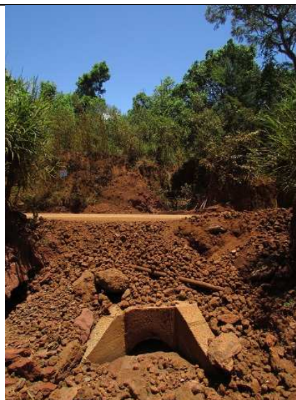
Foto 4: Passagem manilhada obstruída.
