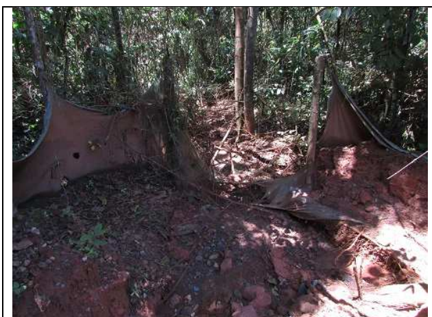
Foto 5: Rompimento de paliçada.
