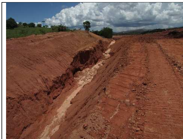
Foto 8: Obra de drenagem na parte mais alta do trecho. Notar processo erosivo e movimentação de sedimentos.
