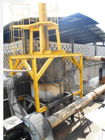
Foto 02. Sistema de limpeza de gás.
