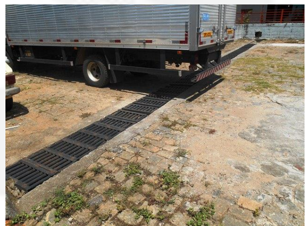
Foto 10. Sistema de drenagem de água pluvial.
