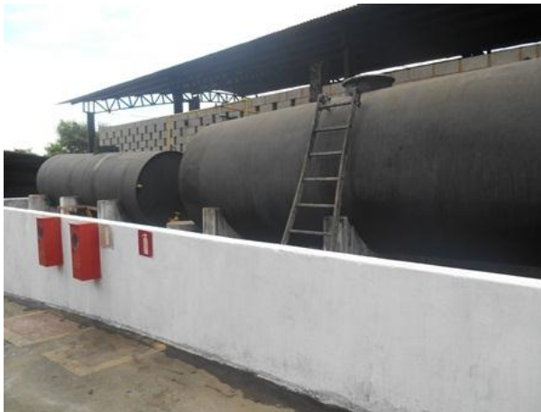
Foto 05. Tanques de óleo BPF.
