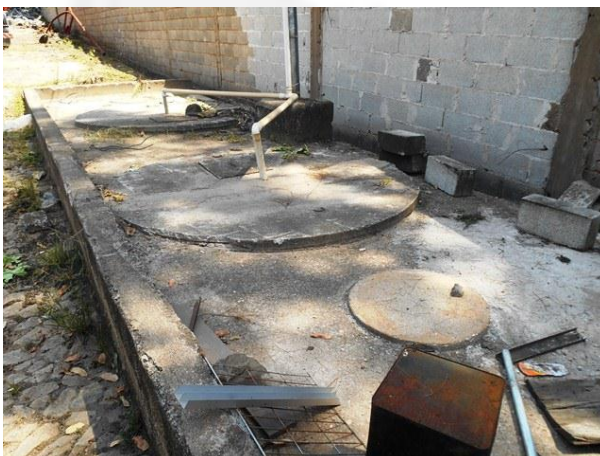
Foto 09. Estação de tratamento de efluentes sanitários.
