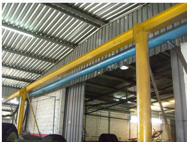
Foto 11. Sistema de recirculação de água.
