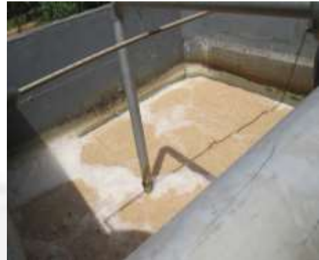
Figura 08: Reator biológico aerado
