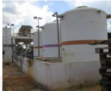
Figura 02: Tanques de produtos químicos
