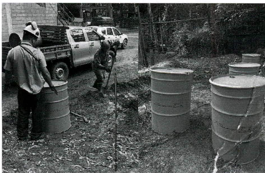
Figuras 7 e 8: Limpeza do local onde ocorreu o vazamento do produto.
