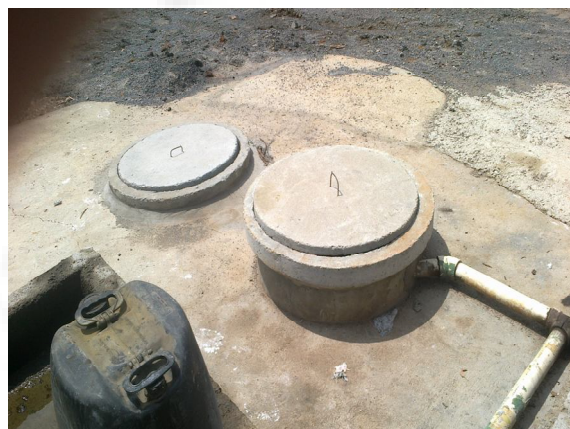
Foto 02. Caixa Separadora de Água e Óleo
