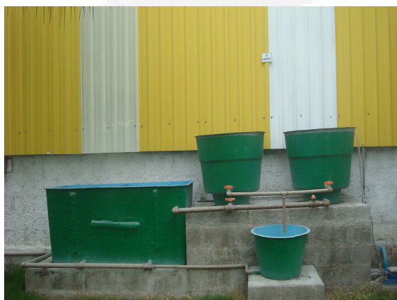
Foto 05. Estação de Tratamento dos efluentes líquidos provenientes do laboratório
