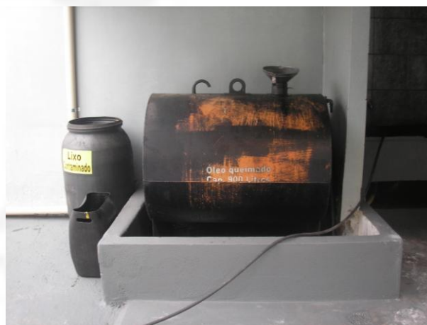
Foto 10. Tanque de armazenamento de óleo queimado, em bacia de contenção.
