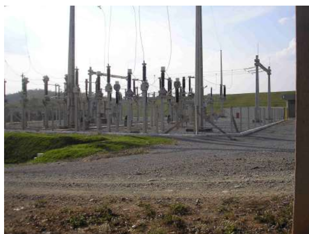
Foto 04. Subestação de energia elétrica
