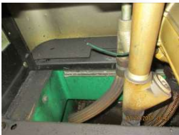
Foto 9 – SUMP das bombas de abastecimento com acúmulo de óleo diesel.
