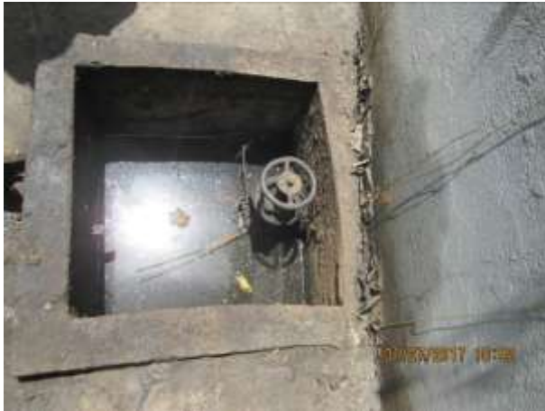
Foto 11 – vazamento da bomba de diesel seguindo para o corpo hídrico
