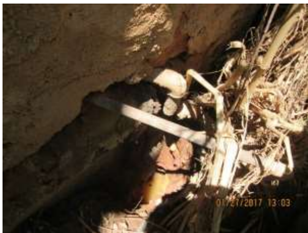
Fig. 17 - Purga da caldeira sendo direcionada diretamente para o curso d'água e causando princípio de erosão.
