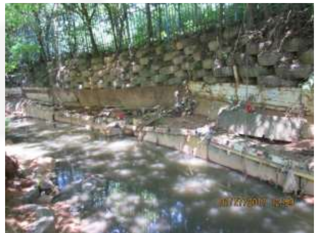
Foto 16 - Contenção realizada dentro do curso d'água sem a devida autorização.
