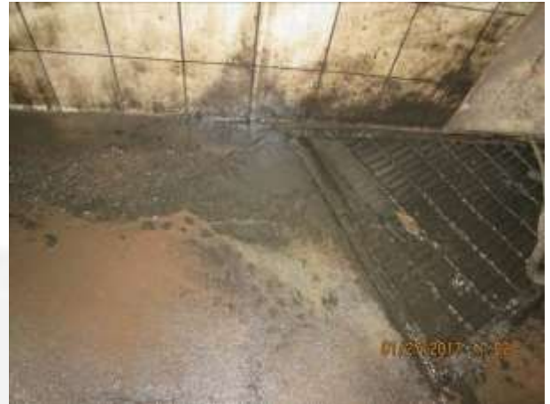
Foto 12 – Caixa de tratamento dos efluentes entupida, localizada no lavador.
