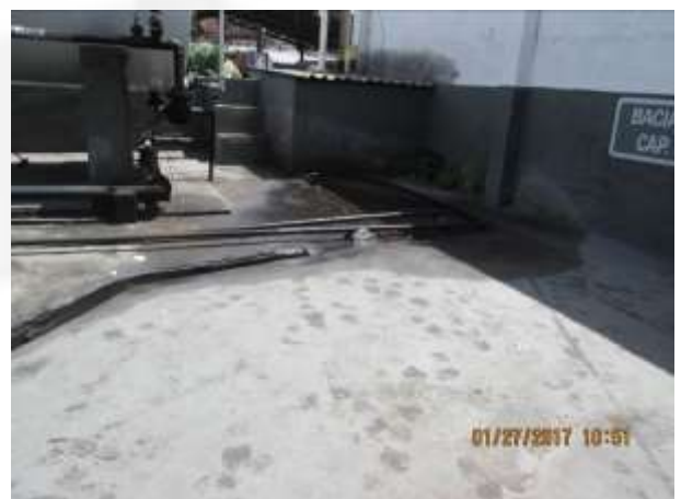
Foto 10 – vazamento de óleo diesel da bomba de recalque do óleo diesel.
