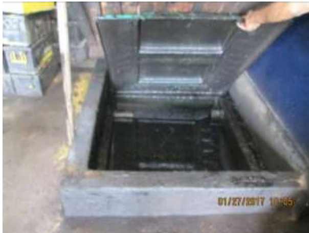
Foto 5 – caixa que deveria servir como separadora de água e óleo totalmente assoreada e cheia de óleo.
