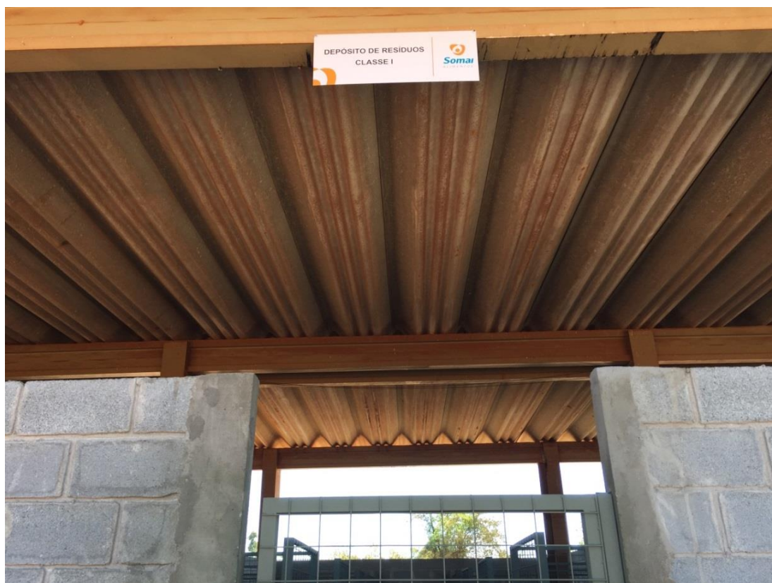
Foto 2 - Depósito de resíduo Classe I
