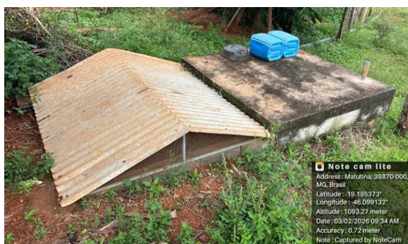
Foto 03. Vista - sistema de tratamento de efluentes sanitários
