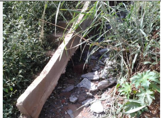
Foto 02. Processos erosivos na drenagem.
