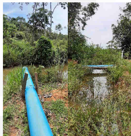
Foto 4. Adutora de transposição da água
