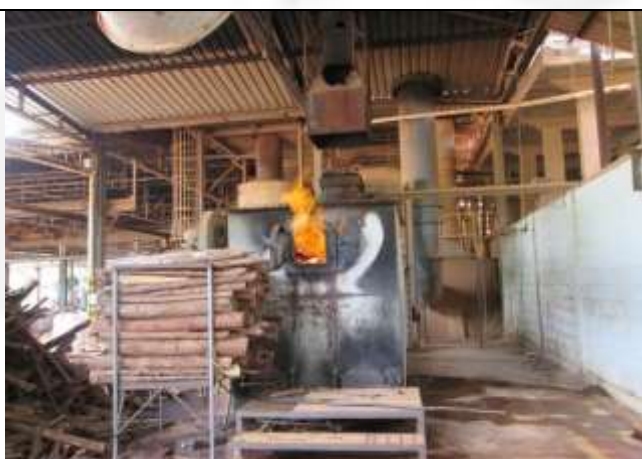
Foto 16: Gerador de Gás Quente usado para secar a bauxita
