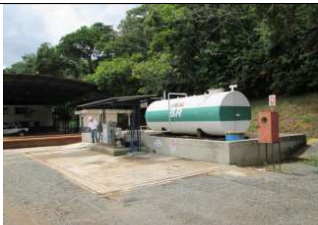
Foto 5: TAC com piso impermeabilizado e canaletas de contenção de vazamento de óleo
