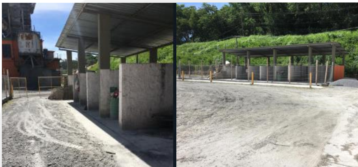
Figura 5.1.1. Baias de armazenamento de resíduos sólidos
