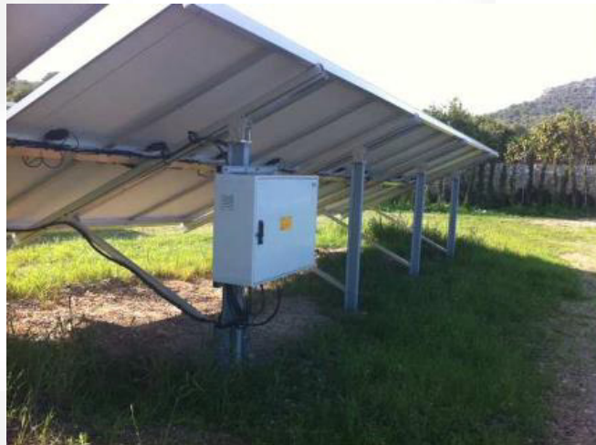
Figura 6. Quadro de nível junto aos painéis fotovoltaicos. Fonte: RCA do empreendimento.
