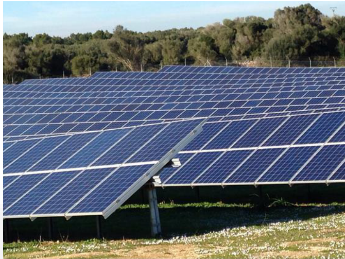
Figura 3. Foto ilustrativa dos painéis solares. Fonte: RCA do empreendimento.
