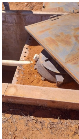
Foto 5. Biodigestor. Fonte: Registro em vistoria.
