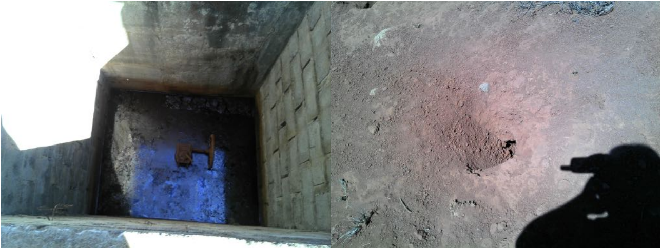
FIGURA 9: A ESQUERDA, DRENO TESTEMUNHO MOSTRANDO O LÍQUIDO BARRADO; A DIREITA, BURACO DE TATU.
