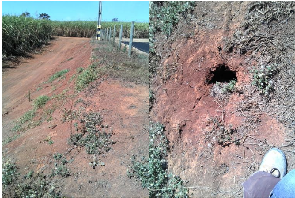
FIGURA 3: A ESQUERDA, TALUDE DESNUDO; A DIREITA, BURACO DE TATU.
