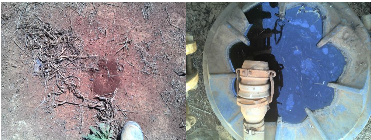
FIGURA 2: A ESQUERDA, FORMIGUEIRO LOCALIZADO NA BERMA DO RESERVATÓRIO; A DIREITA, DRENO TESTEMUNHO SEM GOTEJAMENTO.
