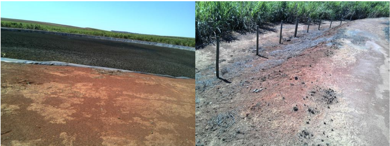
FIGURA 8: A ESQUERDA, VISÃO GERAL DO RESERVATÓRIO DA CASA DE BOMBA III CISTERNA; A DIREITA, TALUDES DESNUDOS.
