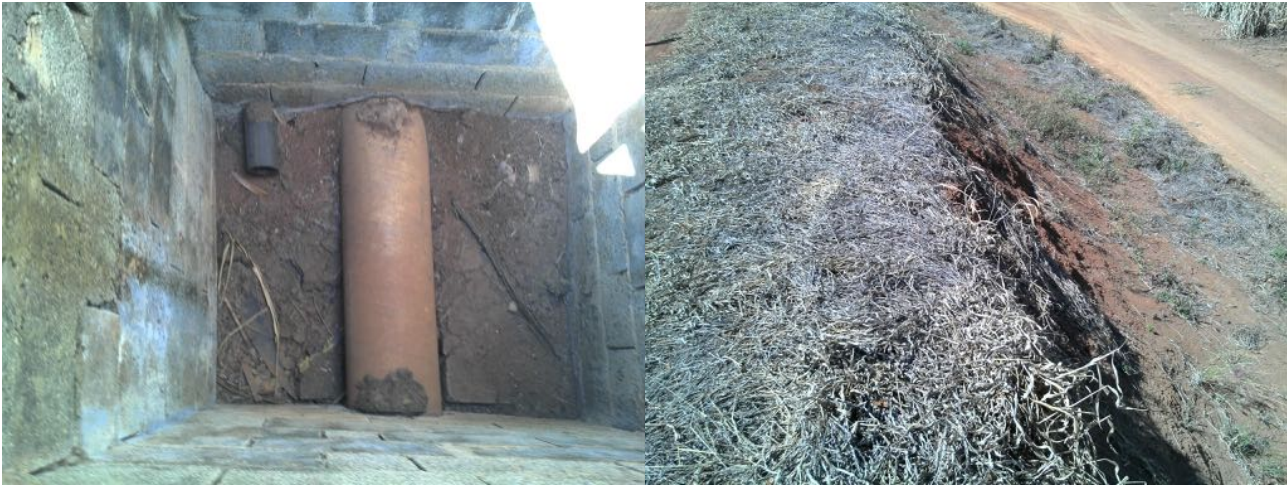
FIGURA 5: A ESQUERDA, DRENO TESTEMUNHO SECO; A DIREITA, TALUDE JUSANTE DESNUDO
