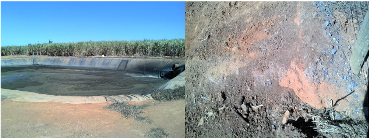
FIGURA 10: A ESQUERDA, VISÃO GERAL DO RESERVATÓRIO III CISTERNA; A DIREITA, SULCO EROSIVO EM ESTÁGIO INICIAL LOCALIZADO NA TRANSIÇÃO DA BERMA PARA O TALUDE JUSANTE.
