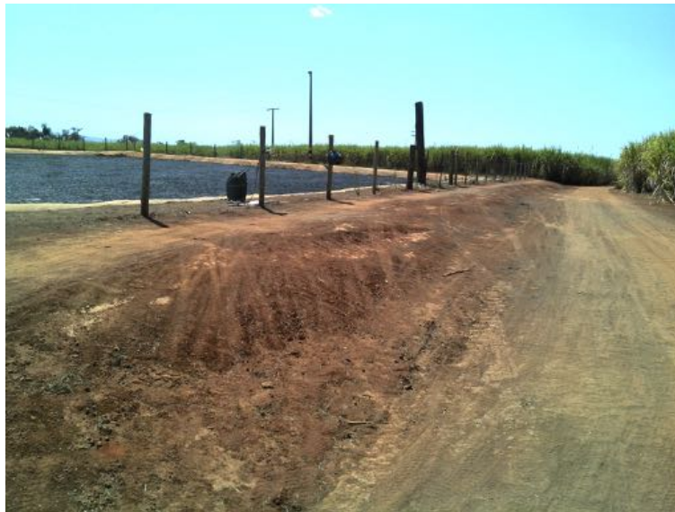
FIGURA 1: VISTA GERAL DO RESERVATÓRIO IV CAPOEIRA DA CANA. NOTA-SE SEUS TALUDES DESNUDOS
