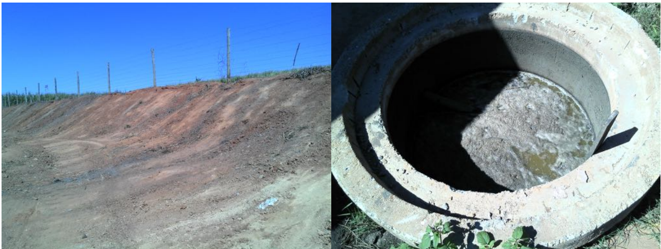
FIGURA 11: A ESQUERDA, TALUDE JUSANTE DESNUDO; A DIREITA, DRENO TESTEMUNHO CONTENDO O LÍQUIDO BARRADO.
