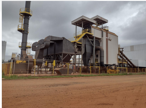
Caldeira movida à biomassa vegetal.
