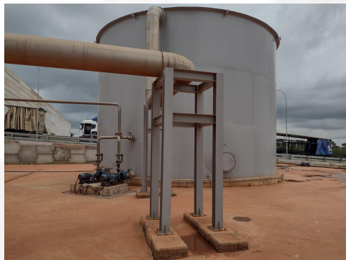
Equipamento da ETE existente
