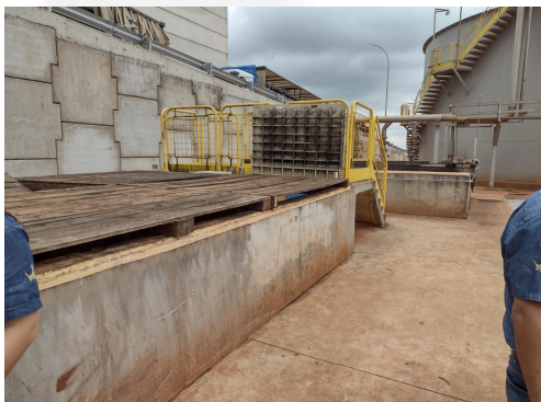
ETE - Gradeamento (tratamento preliminar)
