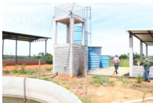
Figura 4: Parte do sistema de tratamento de efluentes líquidos industriais.
