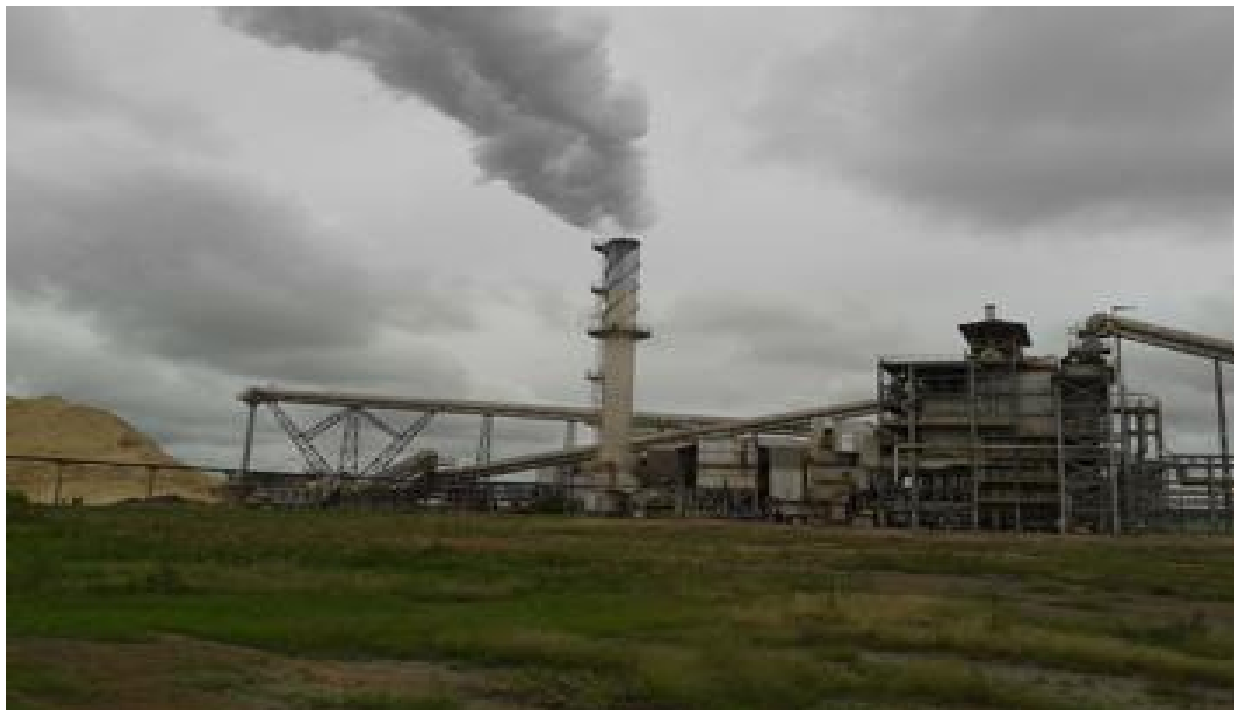
Figura 07- Caldeira utilizada na queima do bagaço de cana-de-açúcar.
