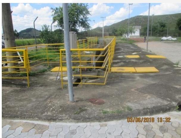
Chegada dos efluentes da Elevatória nº 02 à ETE da CESAMA
