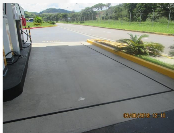
Canaletas e caixa SAO no posto de combustível
