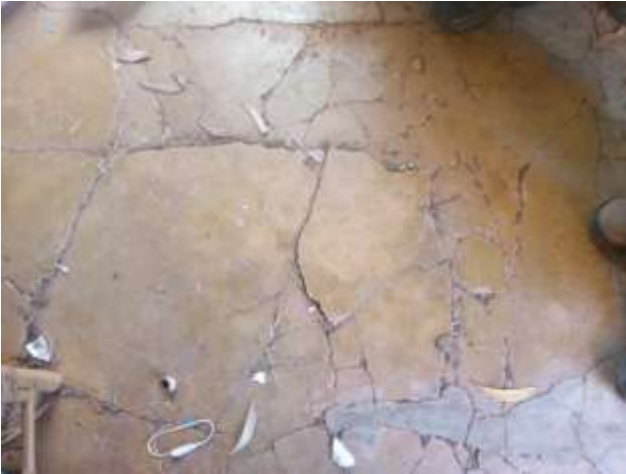
Trincas nas paredes e pisos
