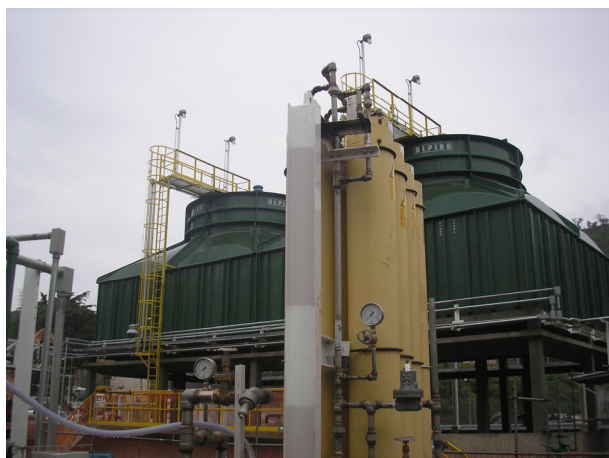
Foto 1: Torre de resfriamento da planta PL9.
