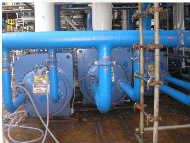
Foto 3: Equipamentos utilizados no processo. A base impermeabilizada possui canaletas que direcionam o fluxo para uma caixa separadora de água e óleo.
