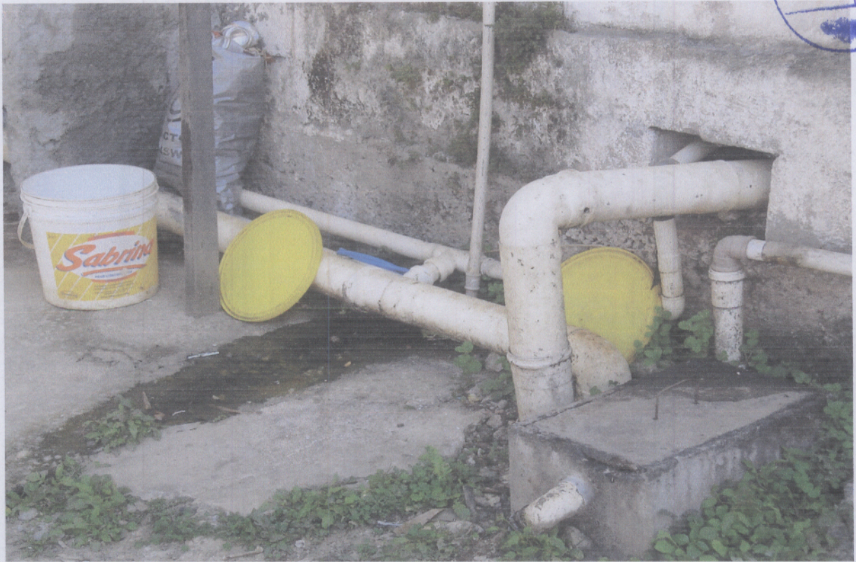
Tubulação de esgoto doméstico e caixa de gordura na parte externa de casa de funcionário sem a presença de moscas próxima ao galpão 01, Granja São Geraldo-02/06/06.
