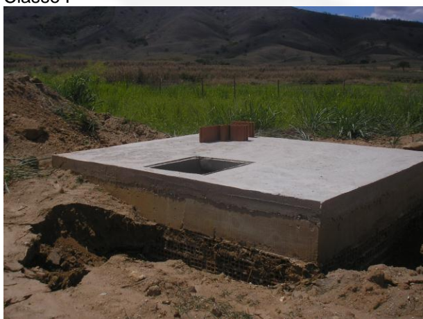
Foto 05. Sistema de Tratamento de Esgoto
