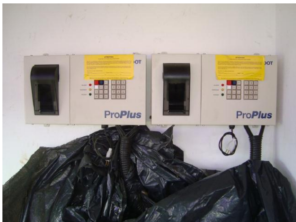
Foto 01. Sistema de Monitoramento Intersticial para os tanques de parede dupla
