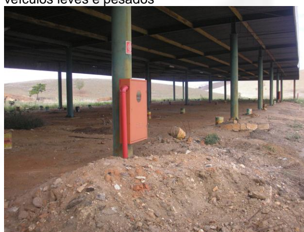
Foto 04. Área de estacionamento coberto sem piso adequado instalado
