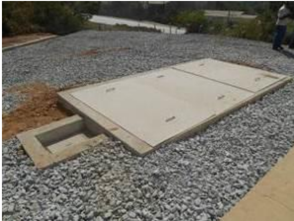
Foto 11. Caixa S&O para tratamento dos efluentes da oficina.
