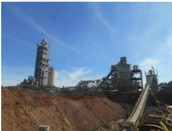
Foto 03. Da esquerda para a direita: Forno de clínquer, silo de clínquer e correia para transporte de matérias primas para produção de cimento.
