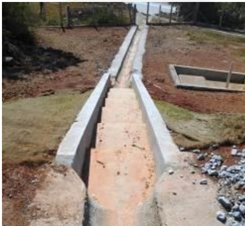
Foto 13. Sistema de drenagem pluvial.
