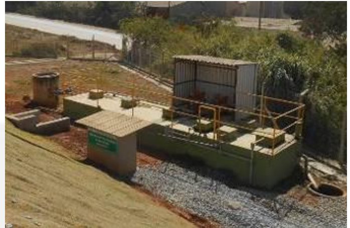
Foto 12. ETE para tratamento dos efluentes sanitários.
