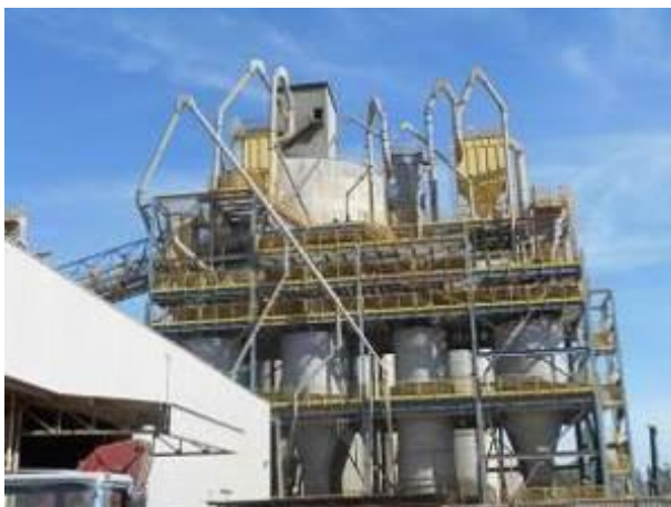
Foto 05. Silos diários para armazenamento das matérias primas.
