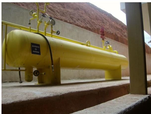
Foto 01. Tanque de armazenamento de amônia.
