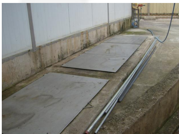
Foto 03. Pré-tratamento - caixas de separação.
