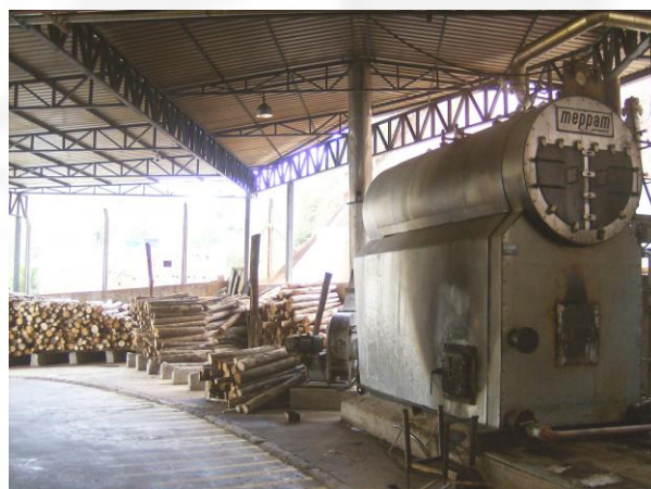
Foto 04. Caldeira à lenha.
