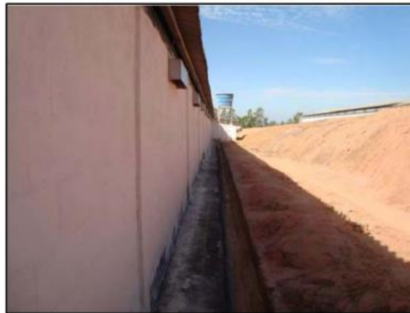
Foto 02. Canaletas de drenagem pluvial
