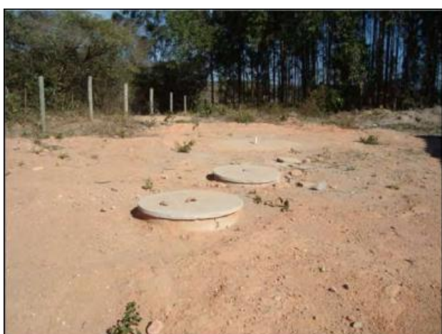
Foto 05. Estação de tratamento de efluentes sanitários
