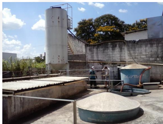
Foto 4: Estação de tratamento de efluentes industriais – chegada do efluente, tratamento físico-químico e leito de secagem do lodo
