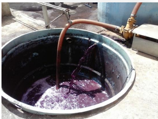
Foto 3: Estação de tratamento de efluentes industriais.
