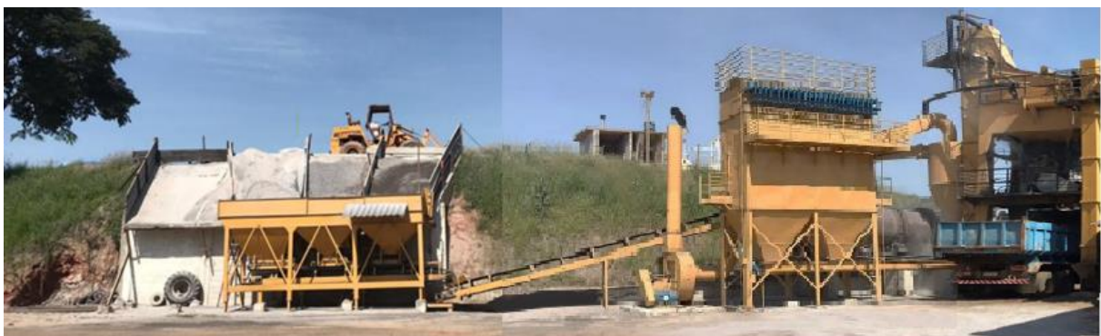
Figura 3 – Usina fixa: silos com matéria prima, esteira, secador, misturador e carregamento – Fonte: RCA/PCA
