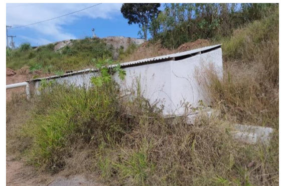
Foto 10: sistema de tratamento de efluentes
