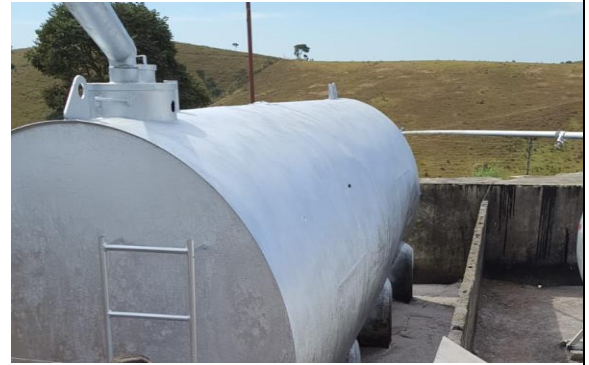
Foto 08: tanque em bacia de contenção
