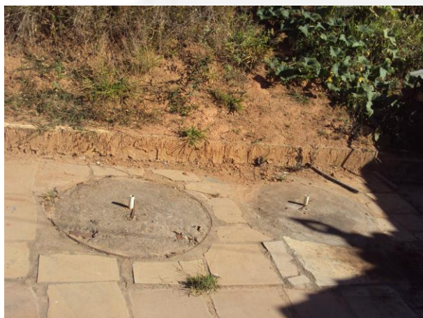
Foto 09. Estação de Tratamento de Efluentes Líquidos Sanitários
