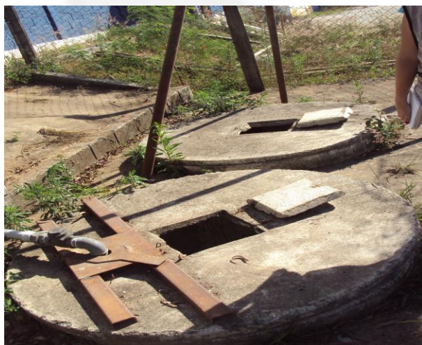
Foto 11. Reservatórios de efluente tratado
