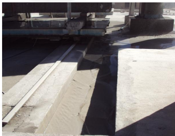
Foto 02. Canaletas que direcionam o efluente para a ETEI
