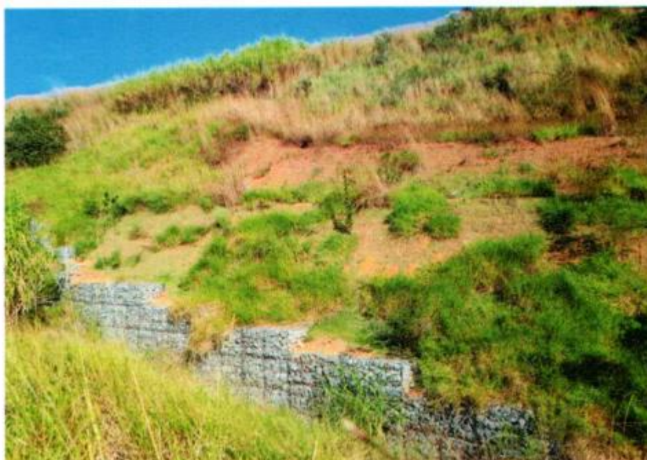
Figura 39. Área recuperada após rompimento do sistema de drenagem pluvial
